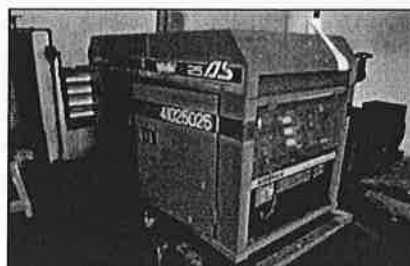
SPK Segama, Lahad Datu, Sabah - Generator Yang Dibekalkan Pada Tahun 2008 Kerap Mengalami Kerosakan (20.08.2013)
