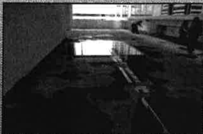
Tempat Letak Kereta – Aras 4 - Air Beriakung Pada Permukaan Lantai (29.10.2013)
