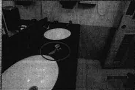
Tandas, Bangunan Pentadbiran - Kedudukan Pili Air Yang Tidak Sesuai (28.10.2013)
