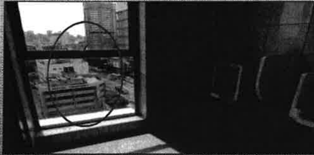
Tandas Letak, Arah 9, Bangunan Pentadbiran - Tingkap Kaca Yang Dipasang Tidak Sesuai Dan Menyebabkan Ketidakelesaan Pangguna. Tingkap Kaca Ini Telah Dipasang Disinua Arah Tandas (30.10.2013)
