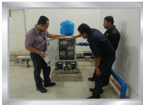
Pemeriksaan dan servis untuk sistem pam penggalak
