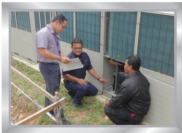
Pemeriksaan dan servis untuk sistem aircond jenis multi split inverter (VRF)
