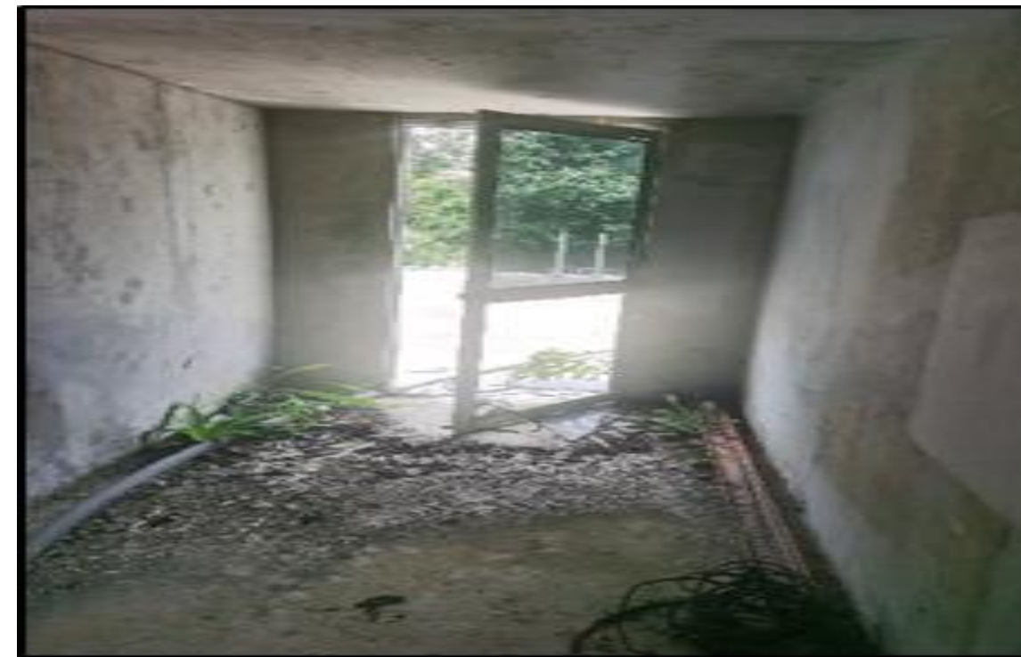
Pintu Penyenggaraan Tangki Air Pecah Akibat Vandalisme
