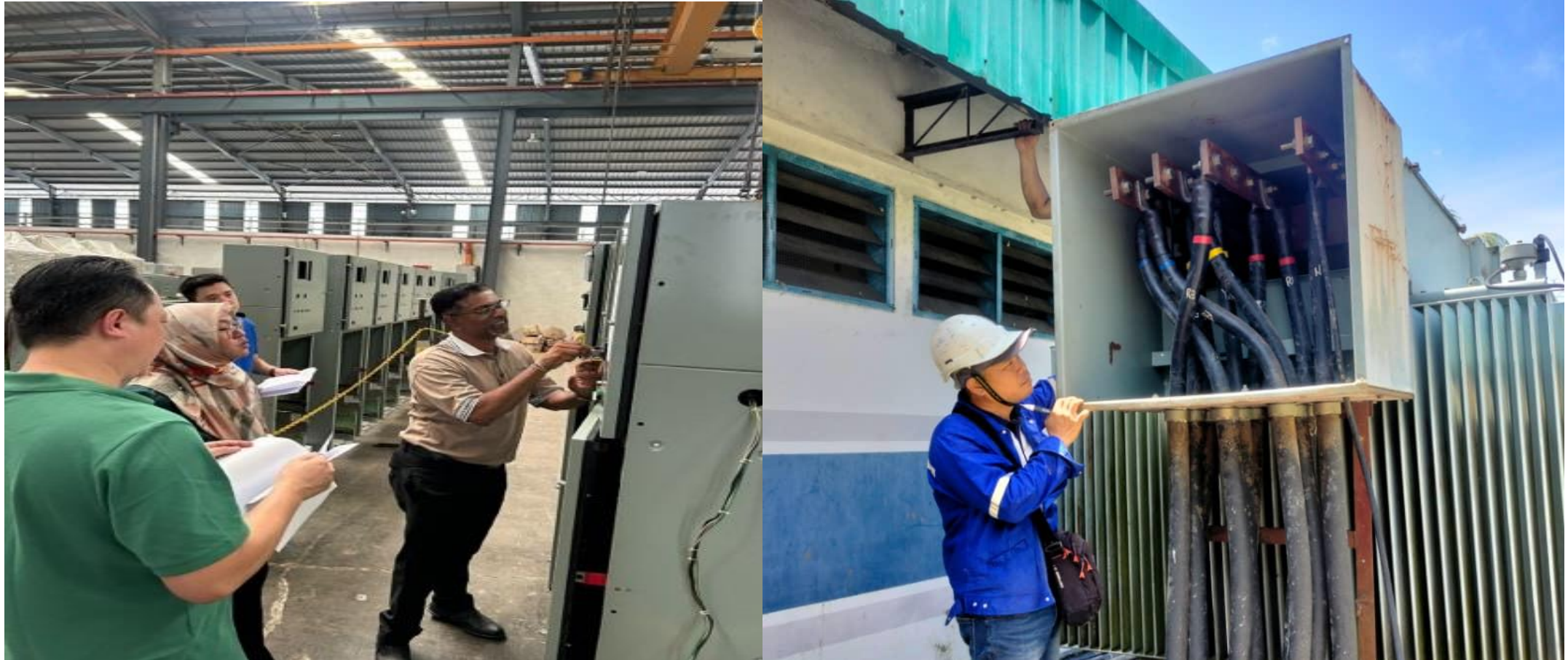
Factory Acceptance Test (FAT) pada Panel dan Switchgear
