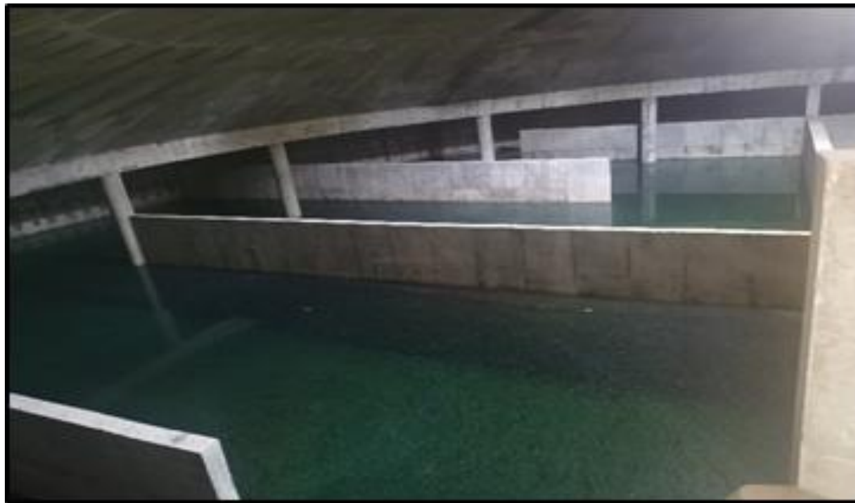
Tangki Air tidak digunakan oleh pihak Lembaga Air Kuching (LAK)
