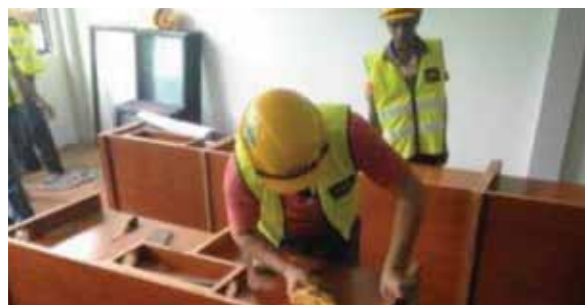
Persediaan untuk servis elektrik pada meja di Bilik Mesyuarat JK
